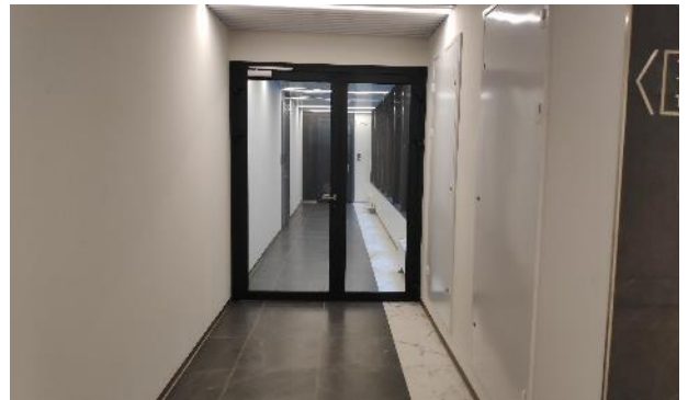
Фото 180. Места общего пользования.
