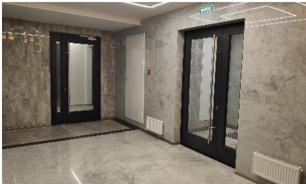
Фото 267. Места общего пользования.
